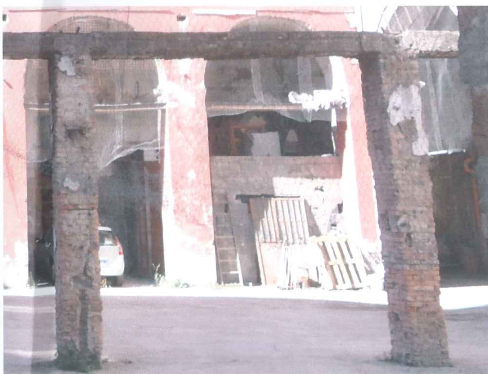
Foto n°14 - Vista del porticato e del manufatto in tufo all'interno del suo perimetro
