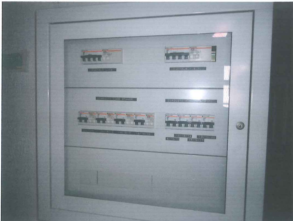
Foto n°30 - il quadro di comando elettrico generale del primo piano
