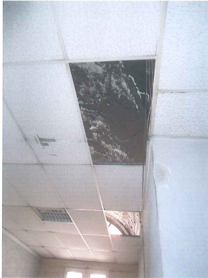
Foto n°29 - La controsoffittatura del corridoio e la soprastante volta a botte con ancora visibili i danni dell'incendio del 1988
